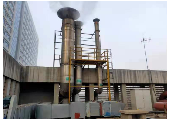
锅炉废气采样平台
